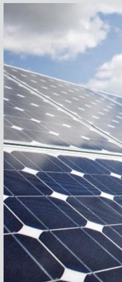
Energetische Modernisierung: Photovoltaik. Foto: Windwärts Energie GmbH (CC)
